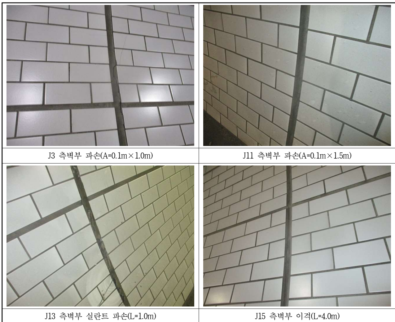
【사진 3.6】 측벽부 손상현황
